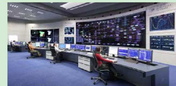
Centro de control remoto
