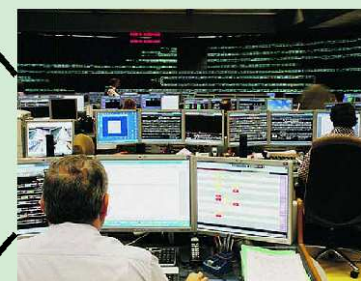
Centralización de datos para cálculos de operación
